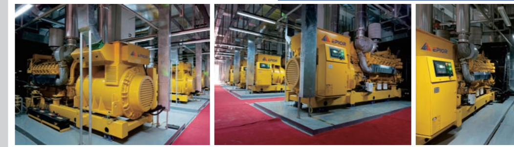
中国联通山西伽峰云数据中心
